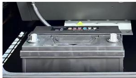
Batterie de démarrage
