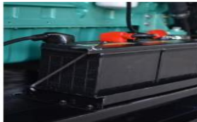
Batterie de démarrage
